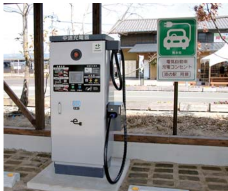
▲電気自動車の充電設備
