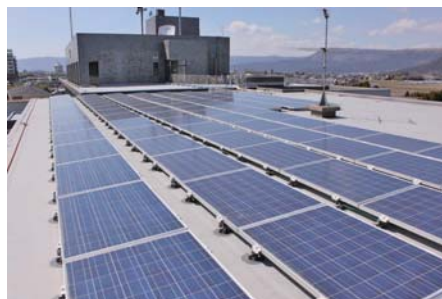
▲一の宮保健センター屋上に設置された96枚のモジュール。
