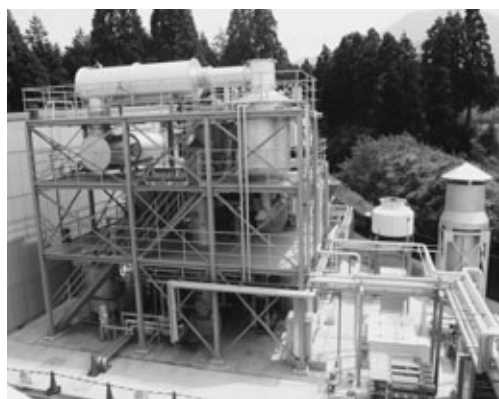
バイオマスエネルギー施設
