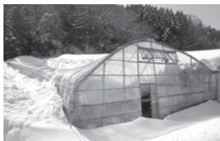
大雪によるビニールハウスの崩壊状況
