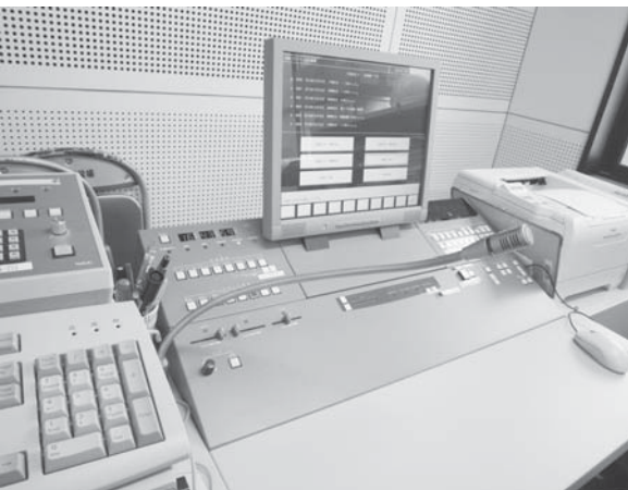
防災行政無線操作卓
