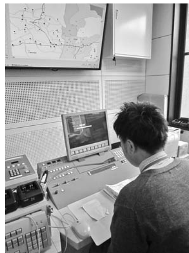
防災行政無線 操作卓
