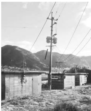
用水機場全景
