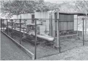
老朽化が進む阿蘇体育館の空調設備
