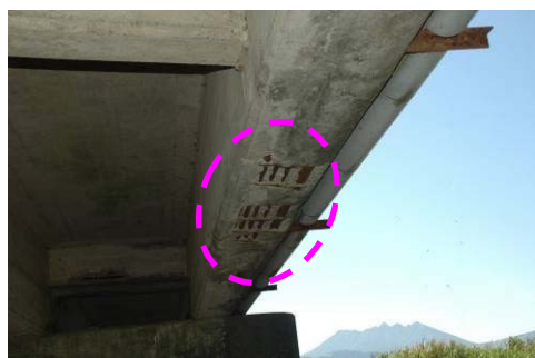
主桁の鉄筋露出
