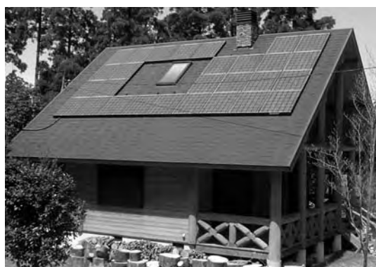
自然エネルギーソーラーシステム
