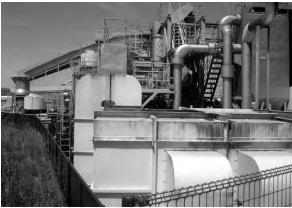
バイオマスエネルギー施設（アゼリア）
