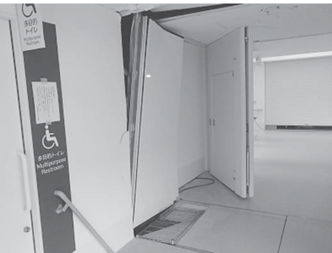
被害を受けた医療センターエキスパンション部分
