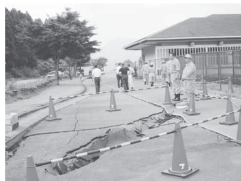
被災したあびか内通路
