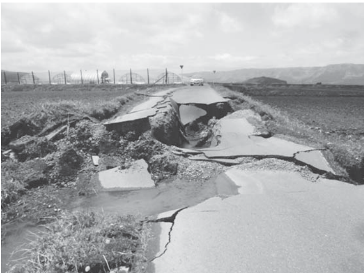
農道に亀裂が走った様子（狩尾地区）
