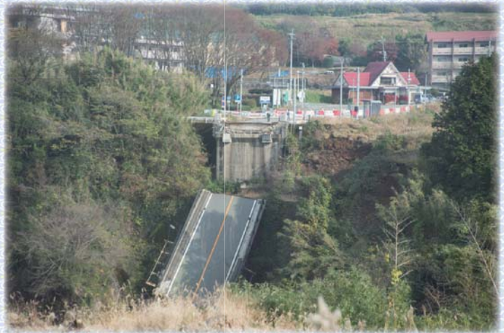
地震で崩落した阿蘇大橋
