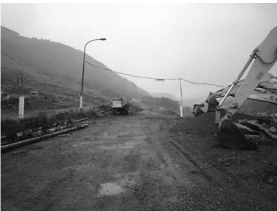
国道57号（阿蘇大橋付近）
