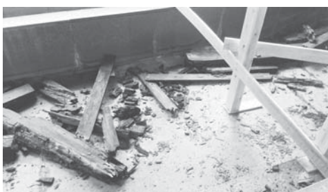
夢の湯天井崩落
