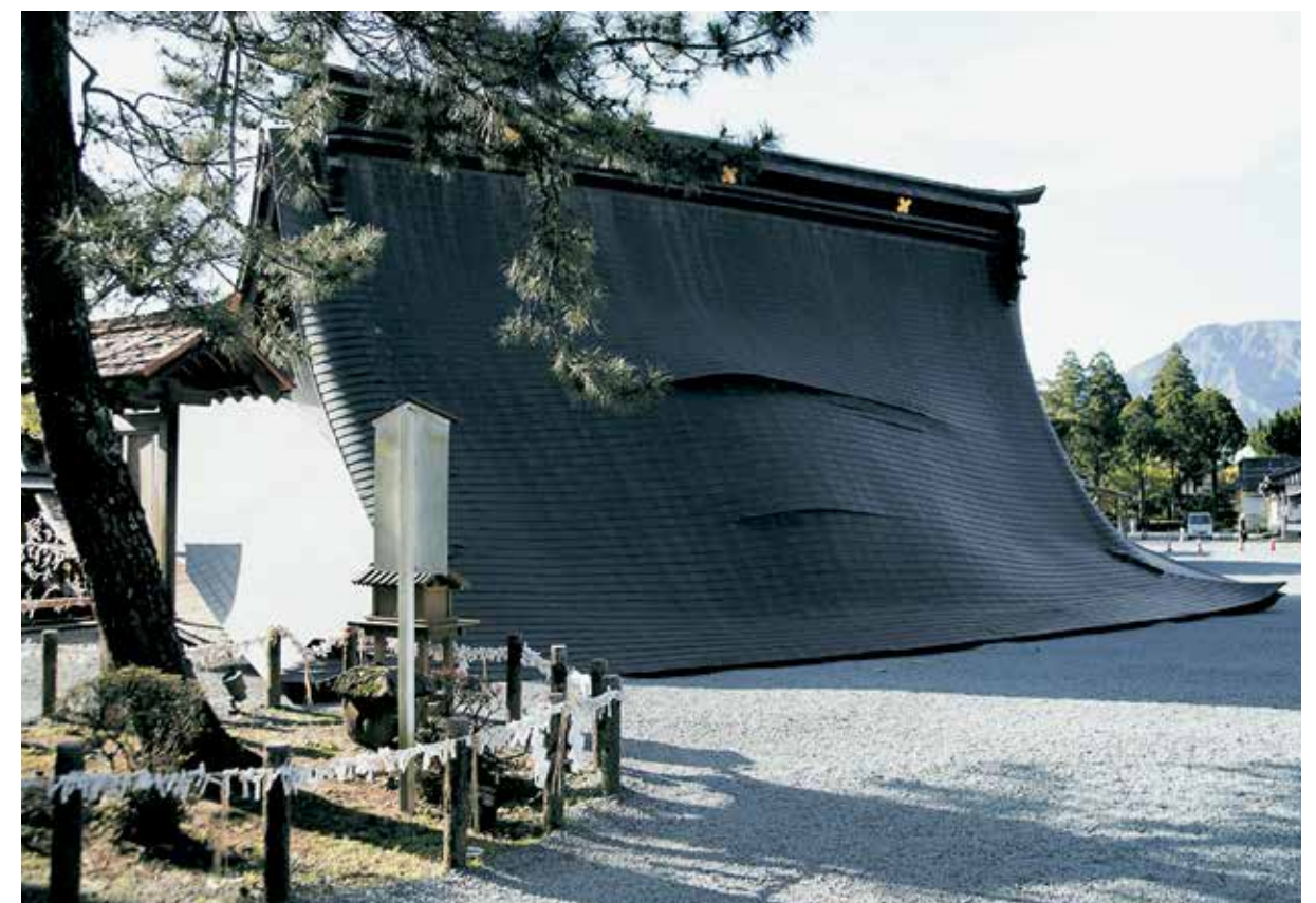
倒壊した楼門(拝殿側から)
