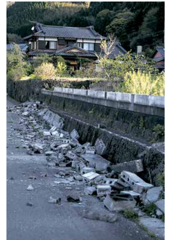
崩れたブロック塀(古城)
