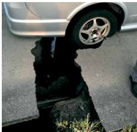
道路の亀裂に落ちた車(的石)
