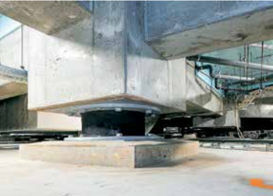
地震の被害を最小限に抑えた免震設備
