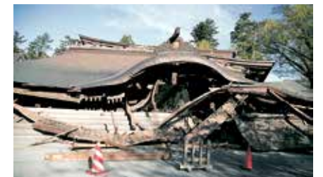
被災直後の楼門
