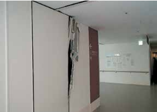
被害を受けたエキスパンション部分(耐震棟と免震棟との接続部分)
