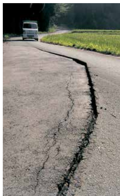
道路の亀裂(小園)
