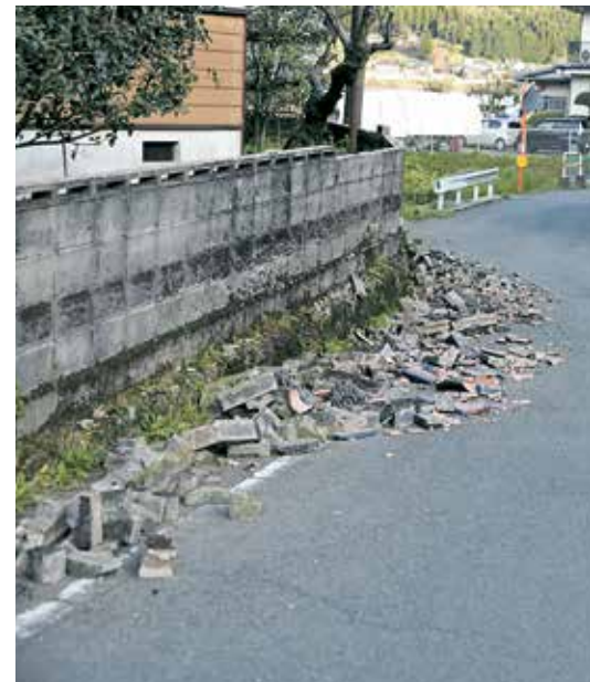
崩れたブロック塀(古城)
