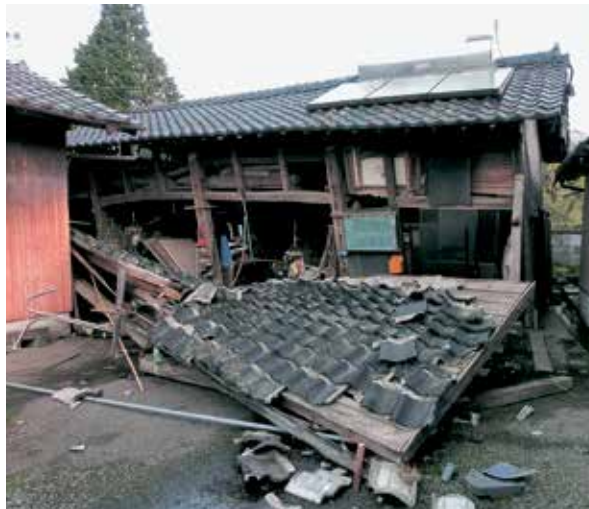
崩壊した納屋(中通)
