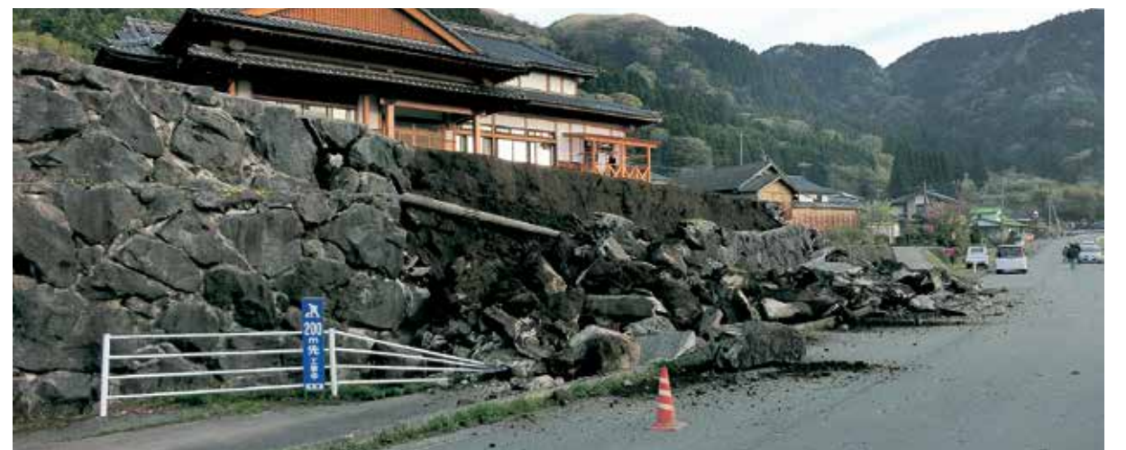
崩落した石垣(中通)
