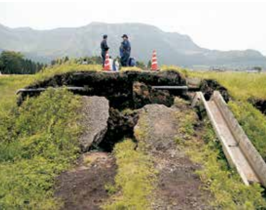
大きな段差により農道や用水路も損傷(狩尾)
