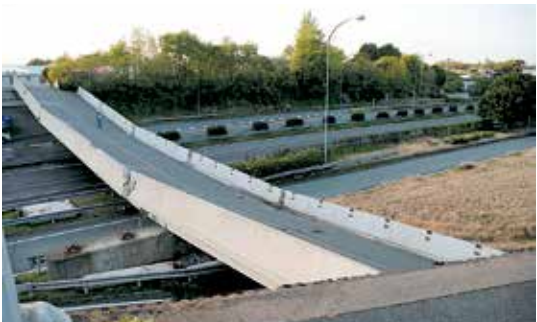
九州自動車道上に崩落した県道の陸橋
