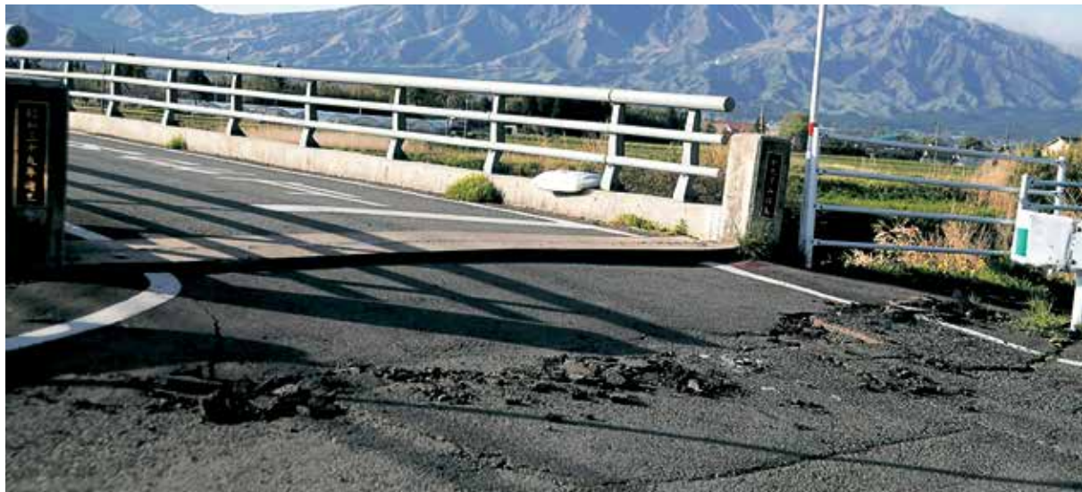
段差ができた片隅橋(中通)
