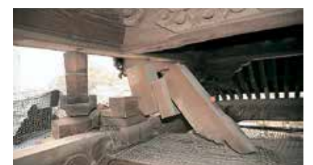
親柱上の組物が破損
