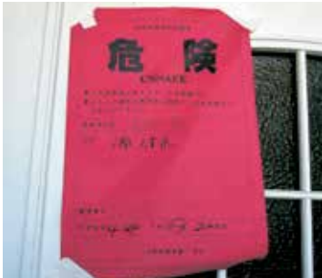
※応急危険度判定 建築物名称など一部画像処理を 施しています
