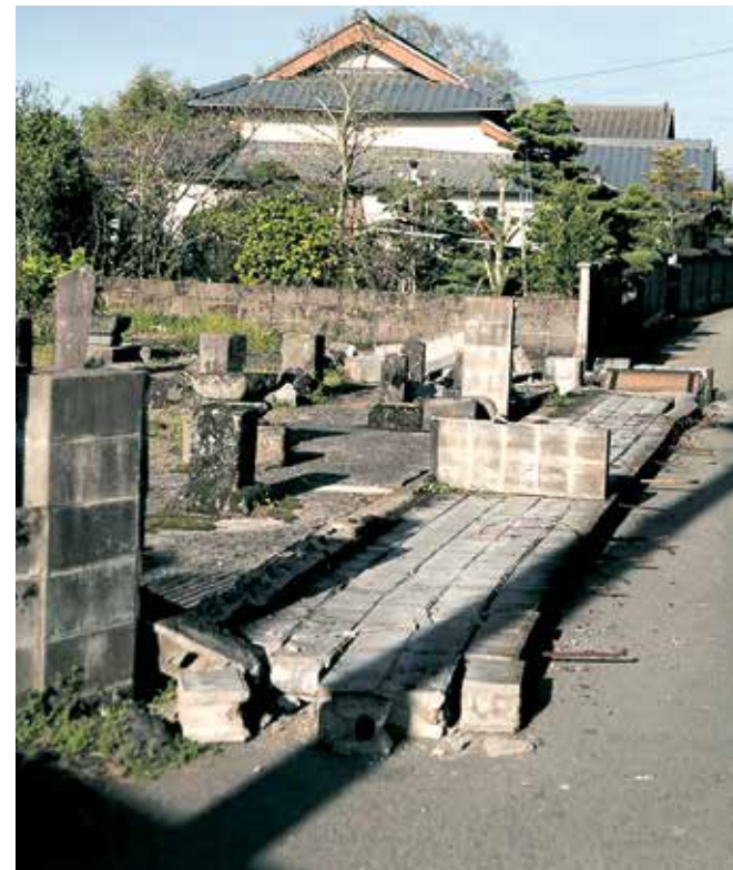
根元から倒れたブロック塀(中通)
