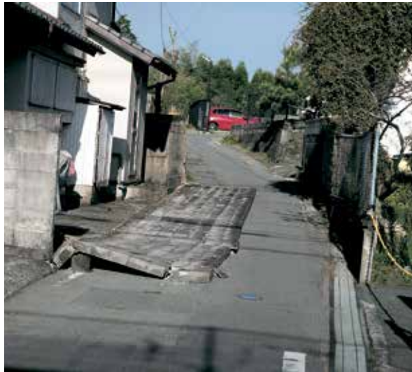
倒れたブロック塀(宮地)
