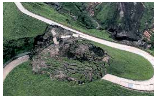
崩落した市道仙酔峡線
