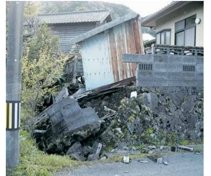
石垣ごと崩れ落ちたブロック塀(古城)
