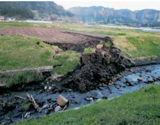
崩れた護岸(坂梨)
