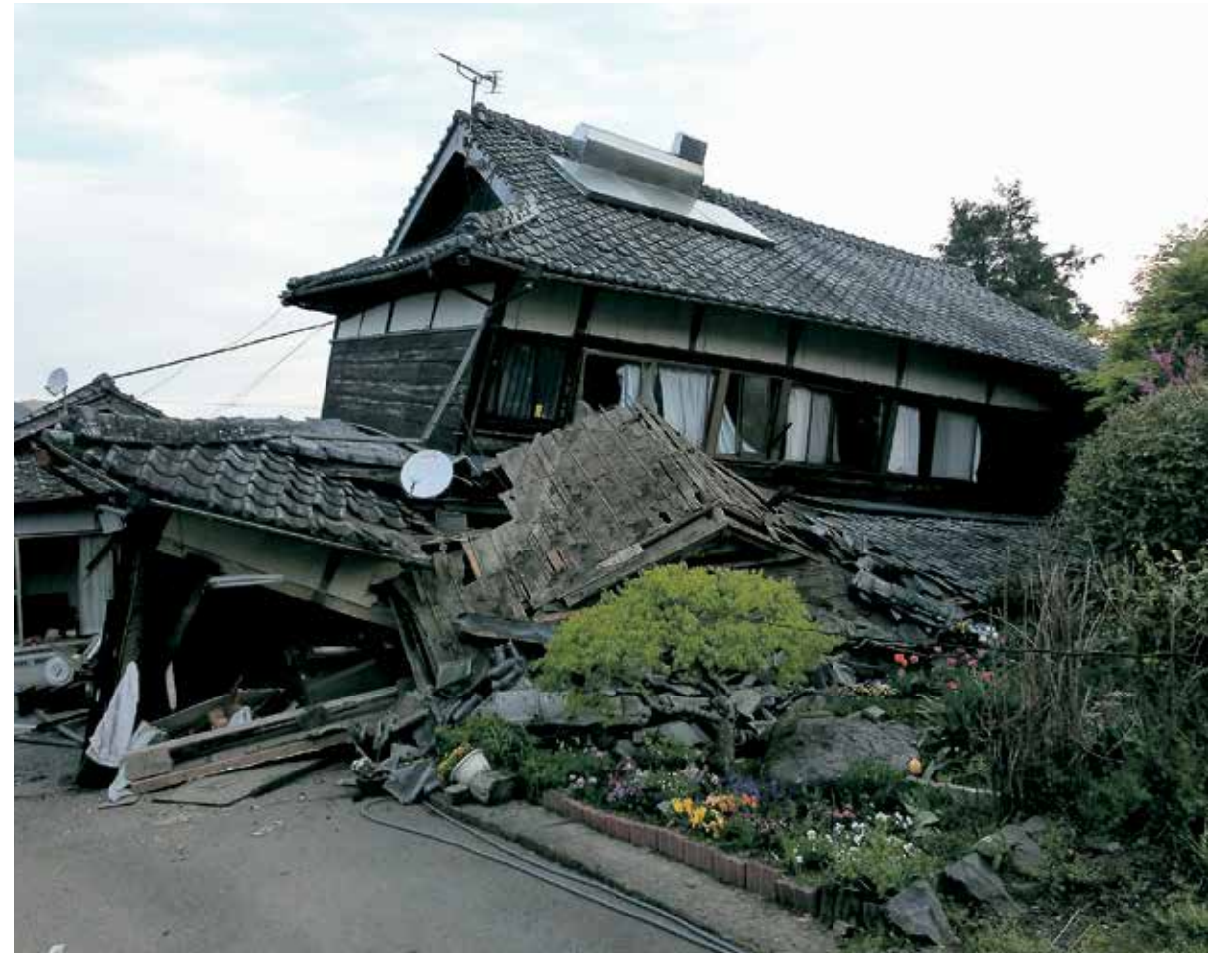
1階部分がつぶれた民家(中通)
