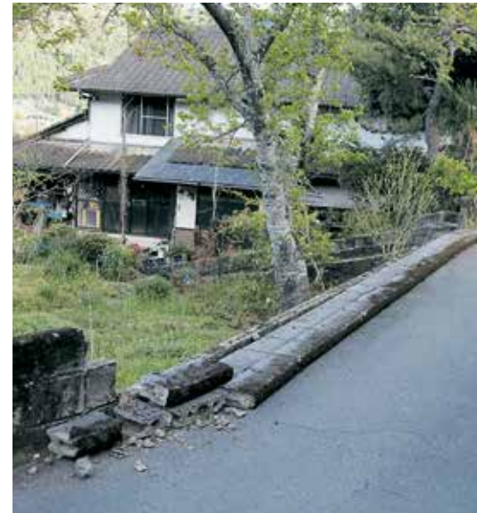
倒れたブロック塀(古城)
