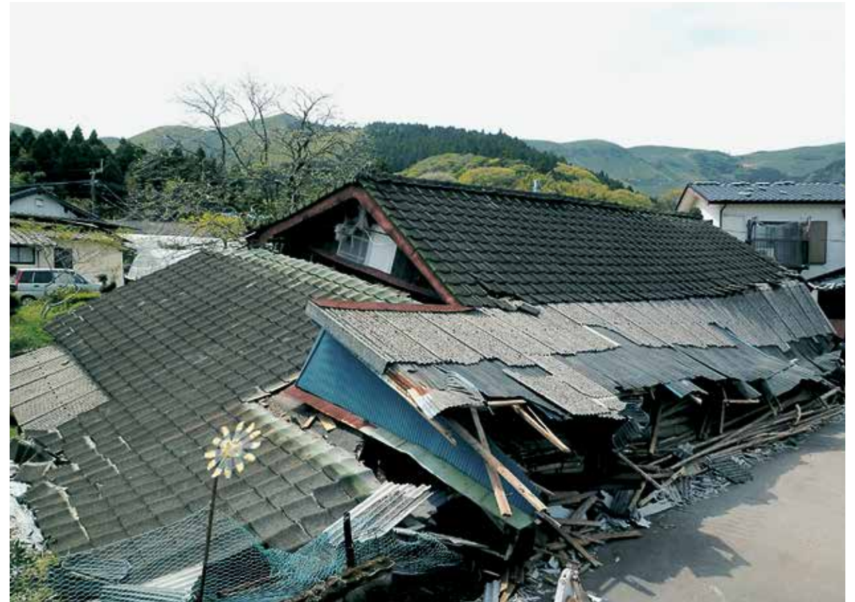
崩壊した民家(車帰)
