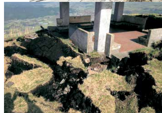
大きな亀裂が入った かぶと岩展望所
