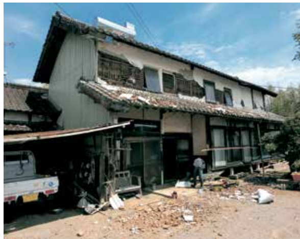
外壁の剥がれた民家(中通)
