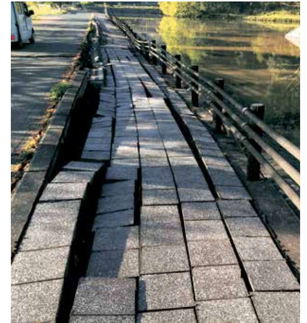
損傷したため池の堤体(車帰)
