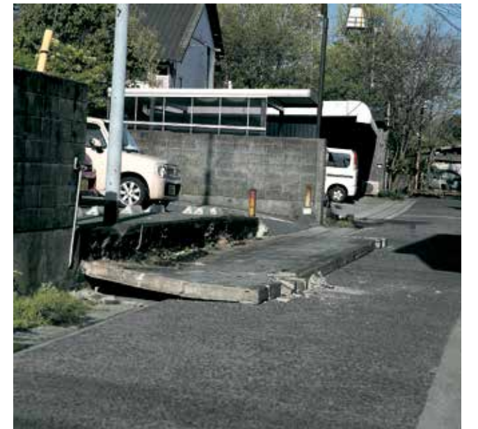
倒れたブロック塀(宮地)
