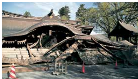
楼門や拝殿が崩壊した阿蘇神社
