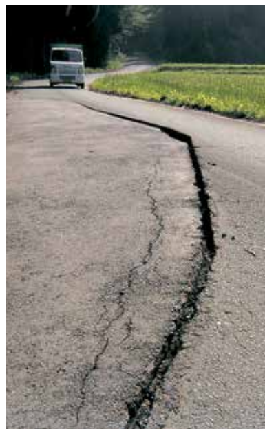
道路の亀裂(小園)
