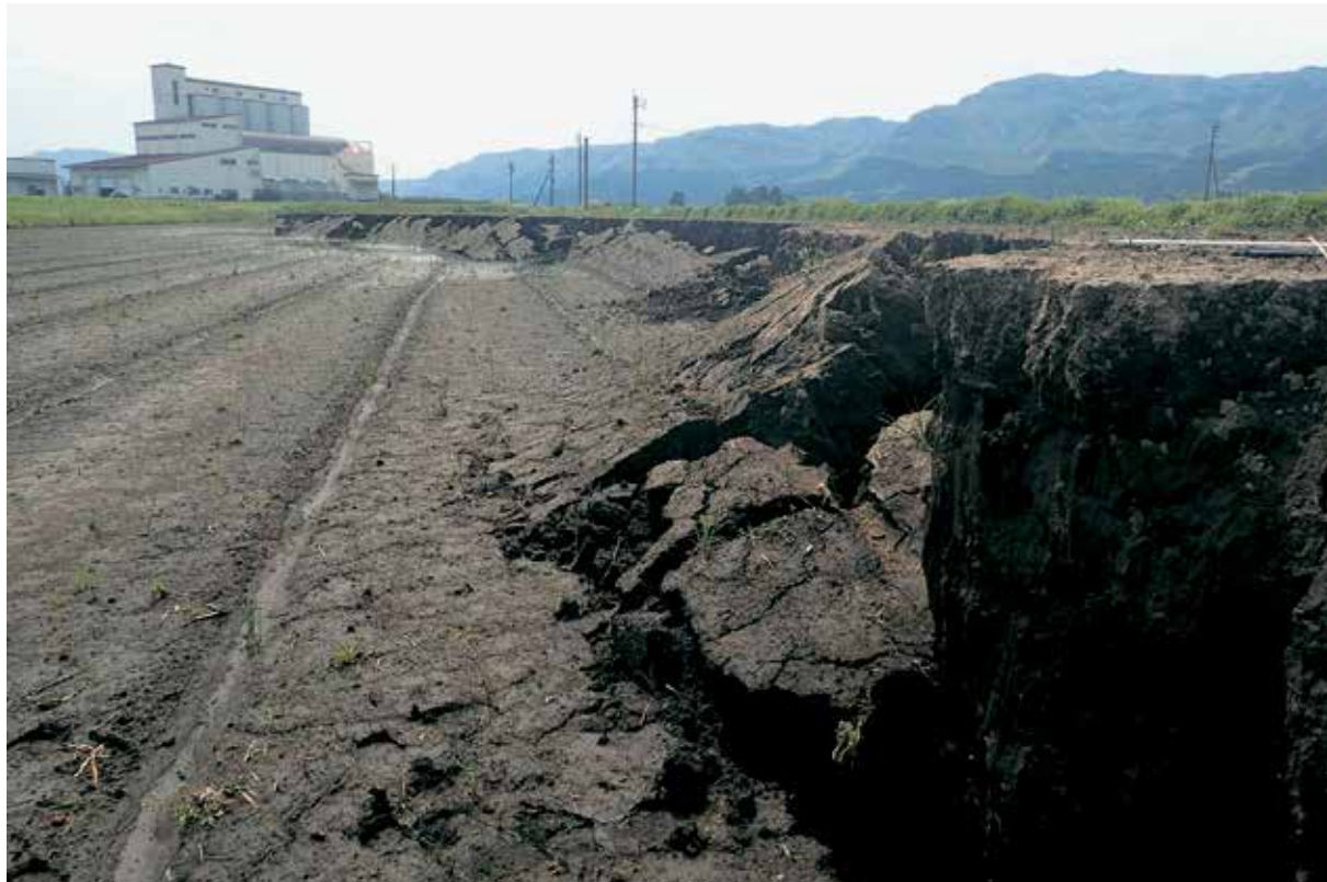
農地の陥没(狩尾)
