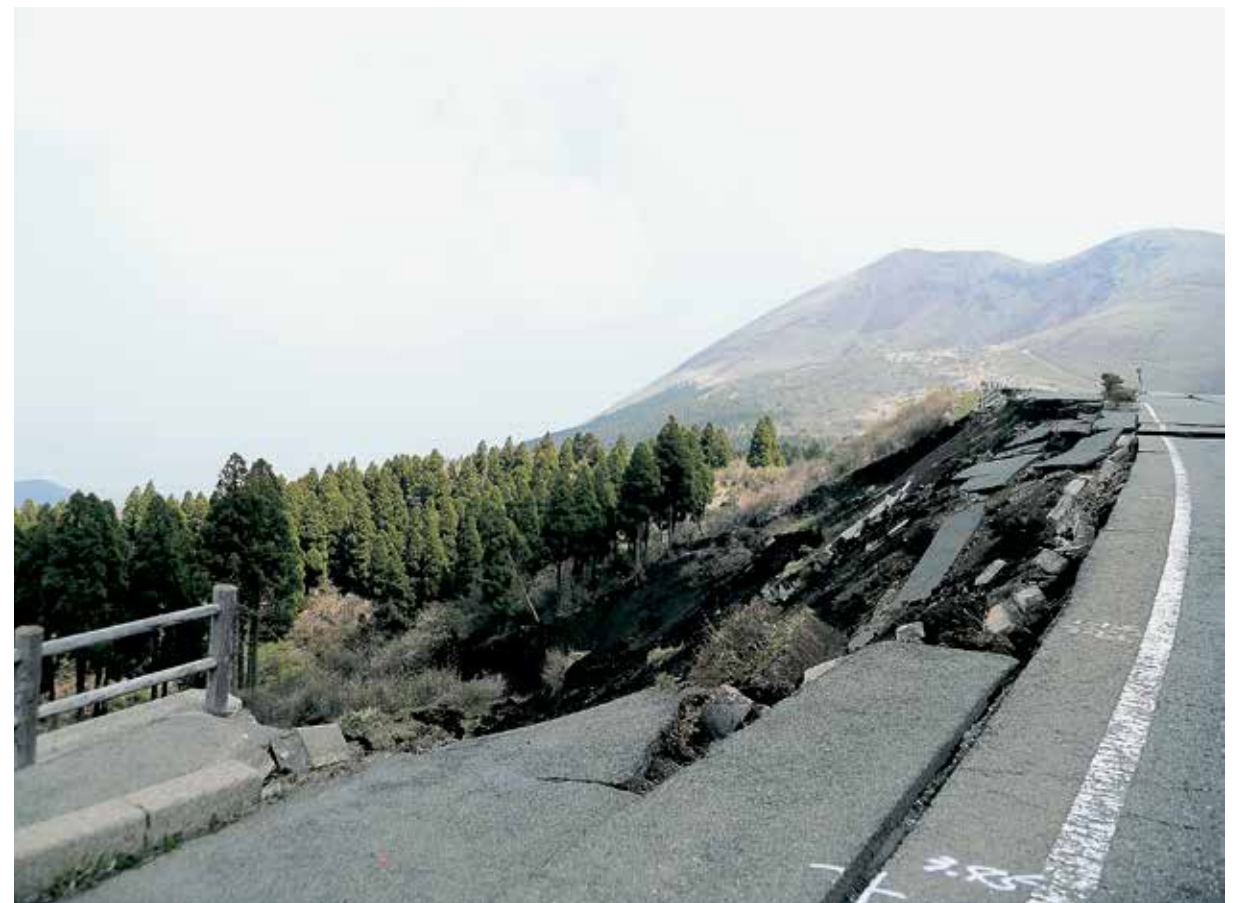
崩落した阿蘇登山道路(草千里近く)
