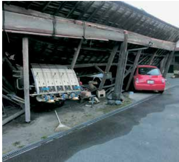
大きく傾いた納屋(中通)
