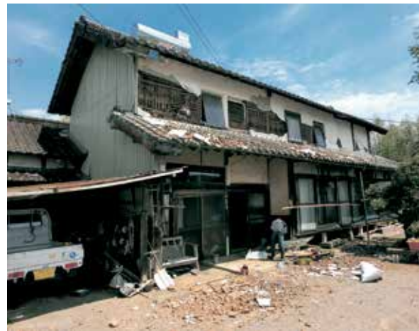
外壁の剥がれた民家(中通)
