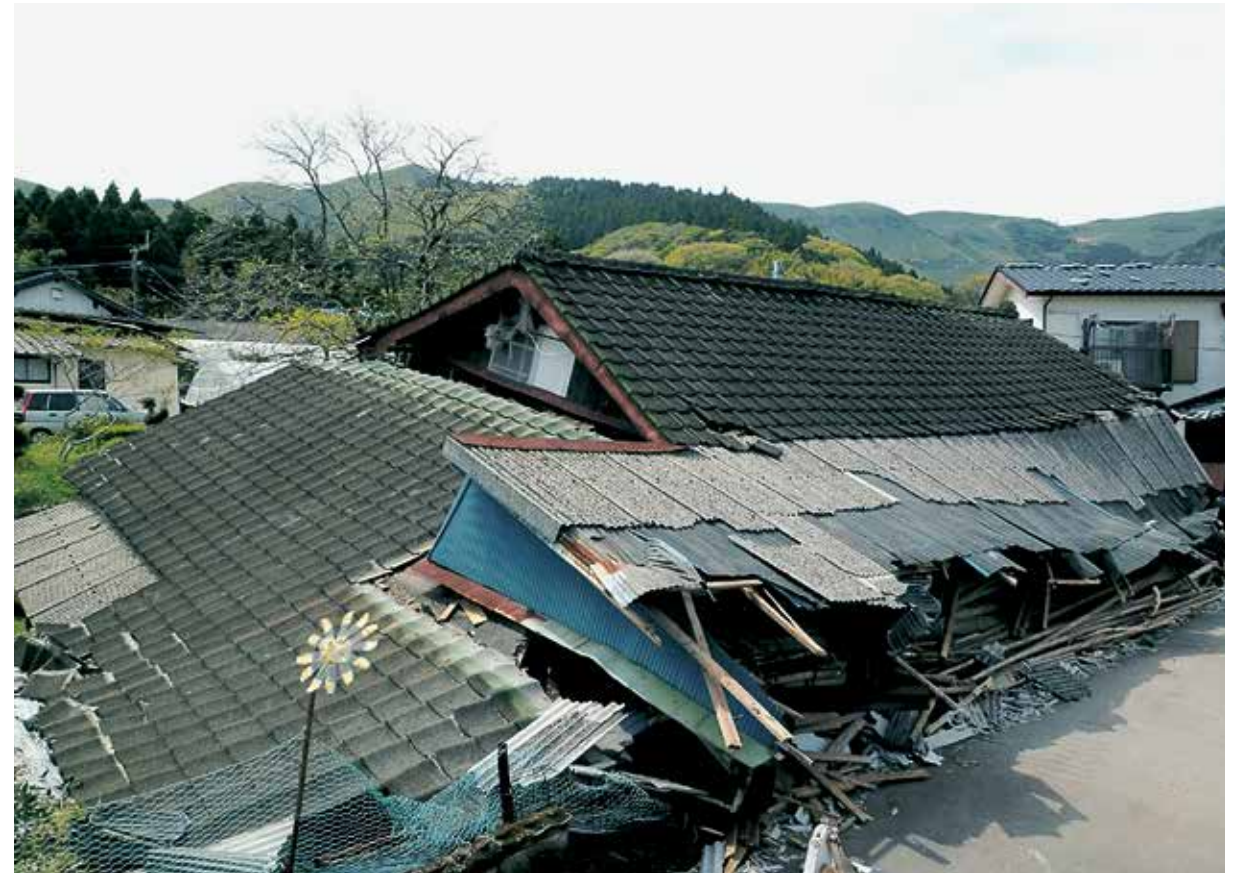
崩壊した民家(車帰)
