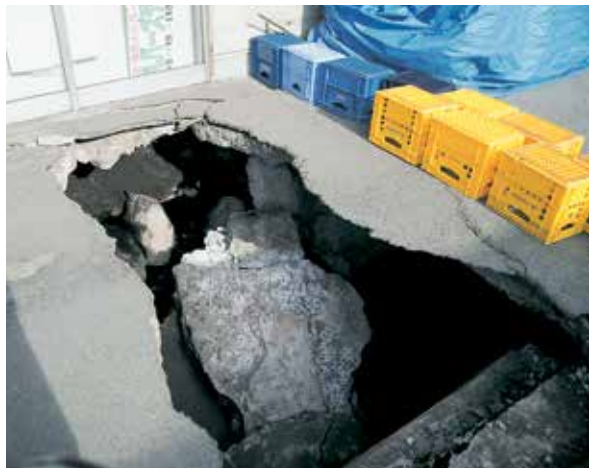
陥没した歩道(宮地)
