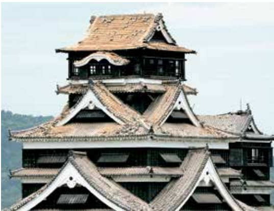
甚大な被害を受けた熊本城天守閣
