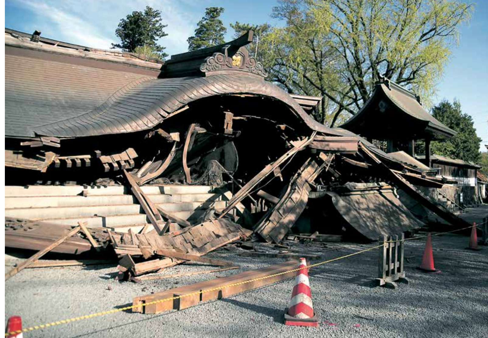
崩壊した阿蘇神社の楼門
