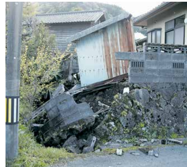
石垣ごと崩れ落ちたブロック塀(古城)
