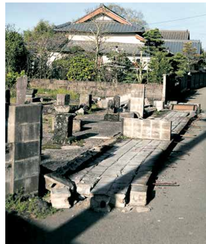
根元から倒れたブロック塀(中通)
