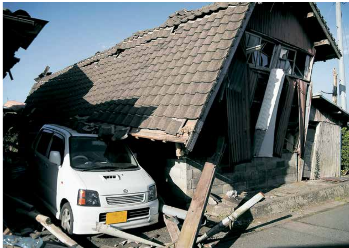
崩れた屋根で車が破損(中通)
