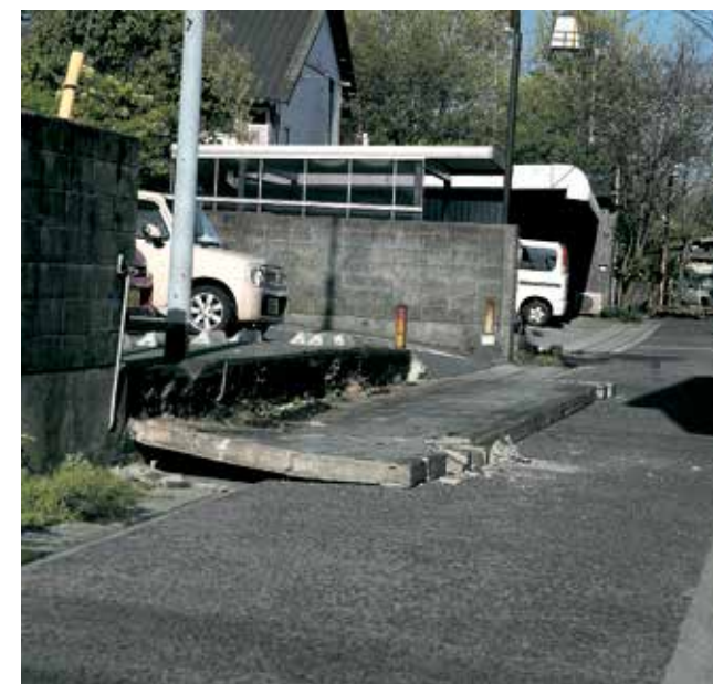
倒れたブロック塀(宮地)
