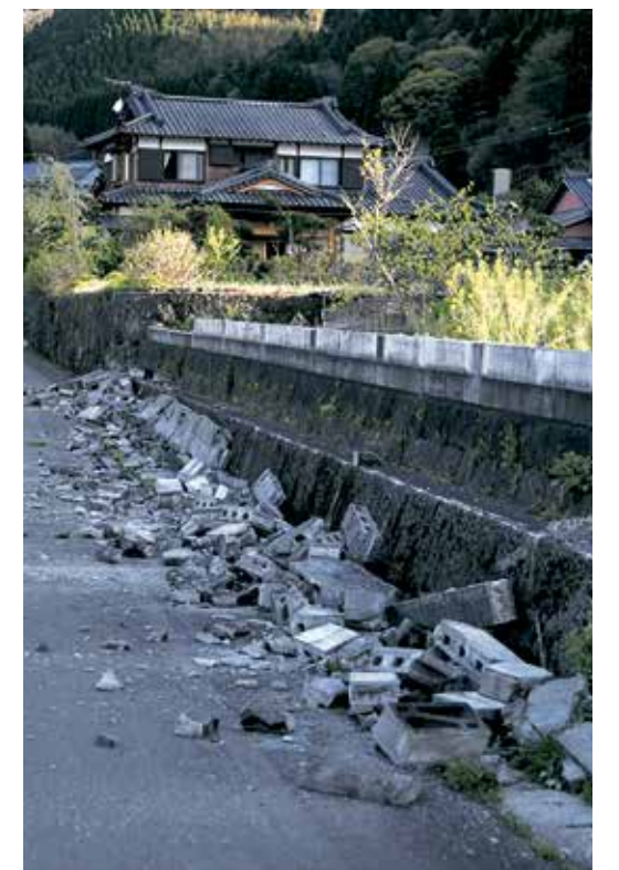
崩れたブロック塀(古城)
