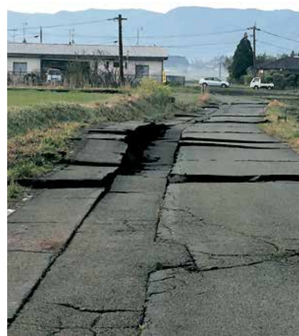
大きな段差が生じた農道(赤水)
