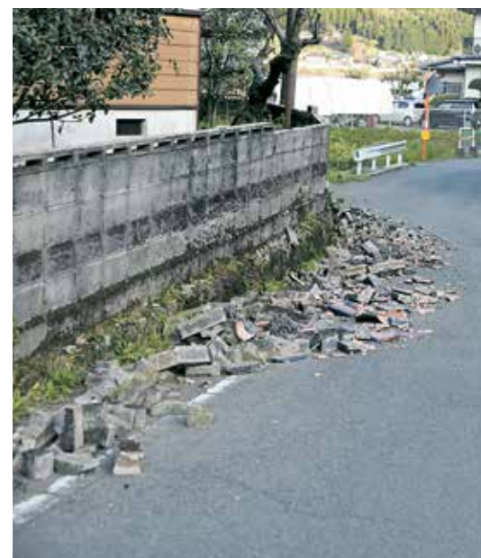
崩れたブロック塀(古城)
