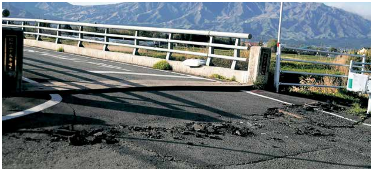
段差ができた片隅橋(中通)
