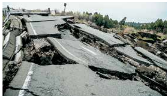
アスファルトが剥がれ落ちた阿蘇登山道路(県道111号)
