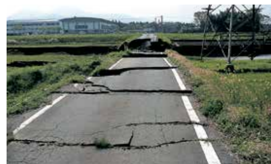
周辺の農地と合わせて陥没した市道阿蘇西小学校黒川堤防線
