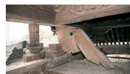
親柱上の組物が破損
