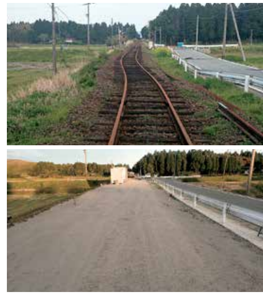
水口付近(阿蘇―内牧間)の地震後の状況(写真上)と復旧工事中の状況(写真下)
