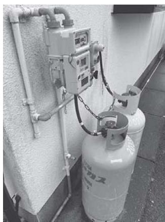
LPガスの設置状況
