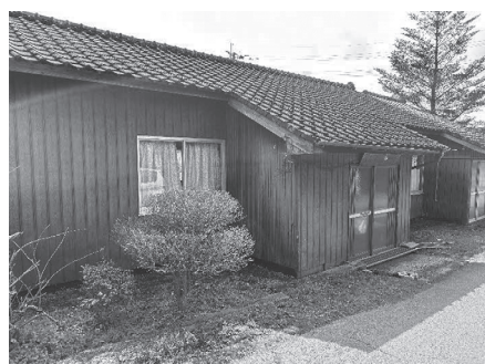
改修等が望まれる地区集会所
