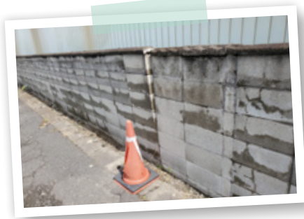
▲危険なブロック塀
