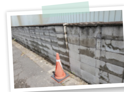
▲危険なブロック塀
