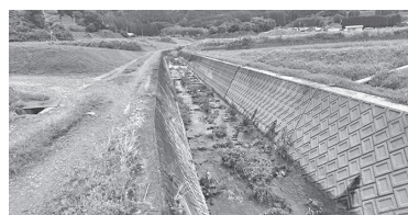
堆積物が撤去された河川
