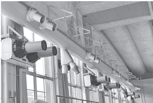
阿蘇体育館に設置された空調
