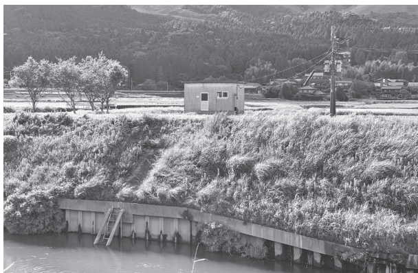
揚水ポンプ（狩尾地区）
